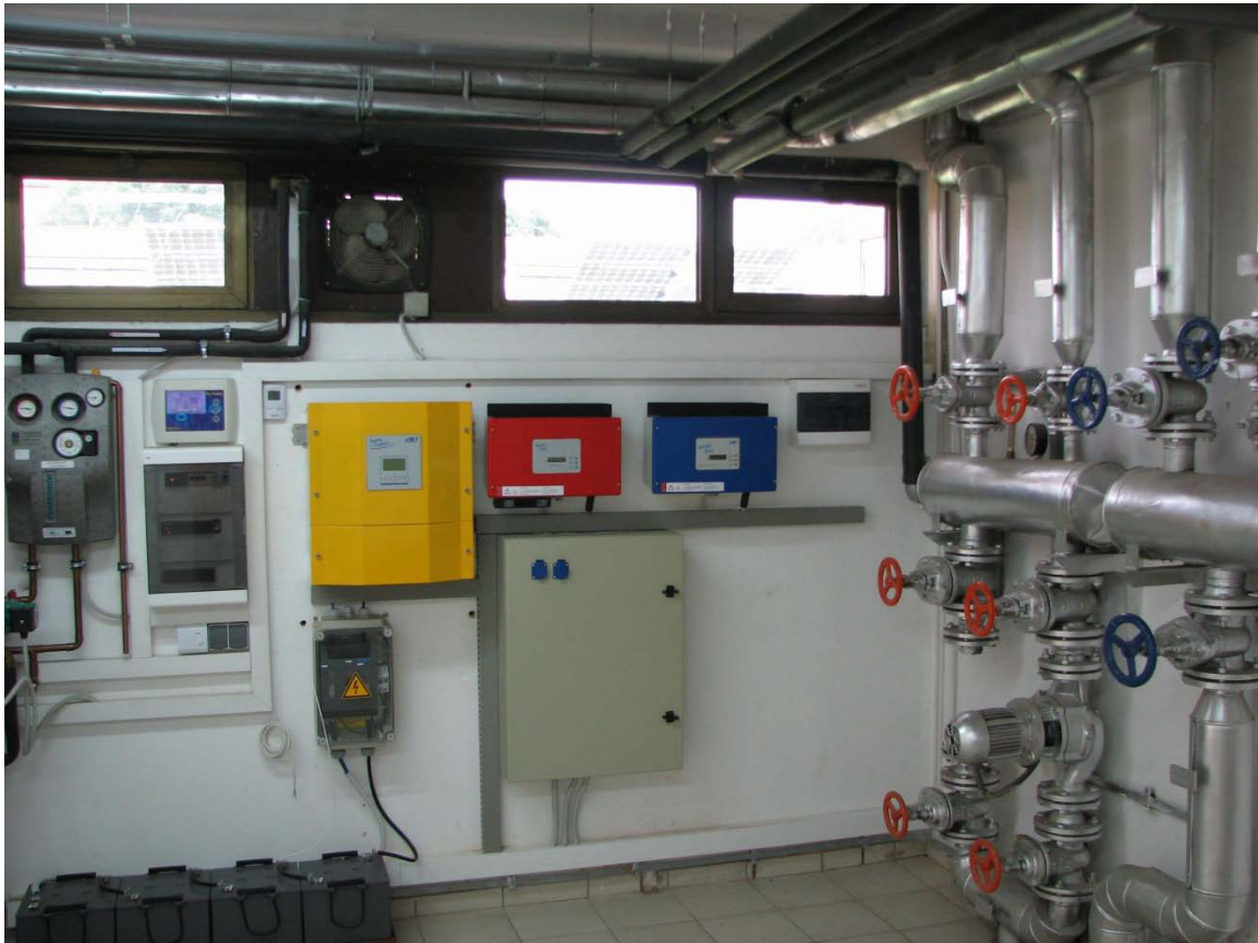
Slika 7.3 Bidirekcijski usmjerivač SI 4500 (žuto), izmjenjivač SB 2500 (crveno), akumulatorska banka (donji lijevi ugao), (Izvor: [Graditeljska škola Čakovec])
