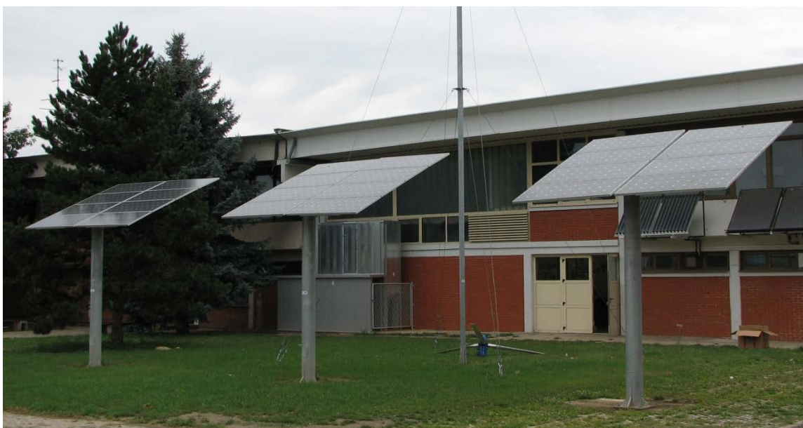
Slika 7.2. Fotonaponsko polje snage 2970 Wp, (Izvor: [Graditeljska škola Čakovec])
