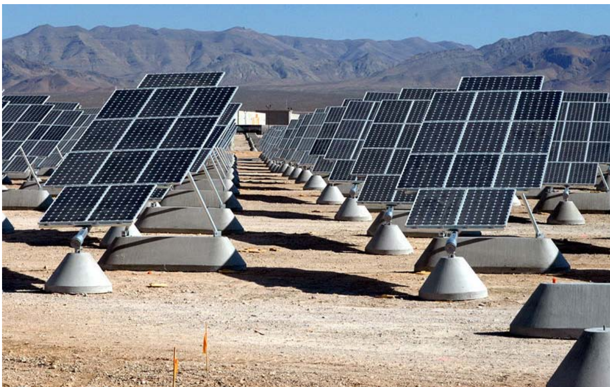
Slika 31. Jednoosni SunPower T20 sustav za praćenje, sa grubom polarnom orijentacijom, u Nellis zračnoj bazi, u Nevadi, USA. Nellis solarnu elektranu je projektirala i izgradila SunPower korporacija [4].
